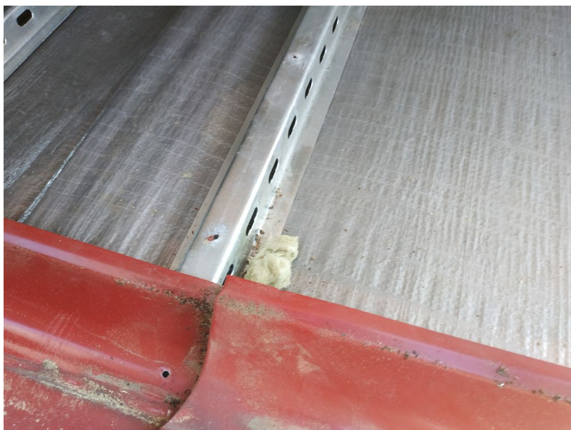
Фото 4.4. Вскрытие №1 в коньке. Отсутствует проклейка стыков гидроизоляционной плёнки.
