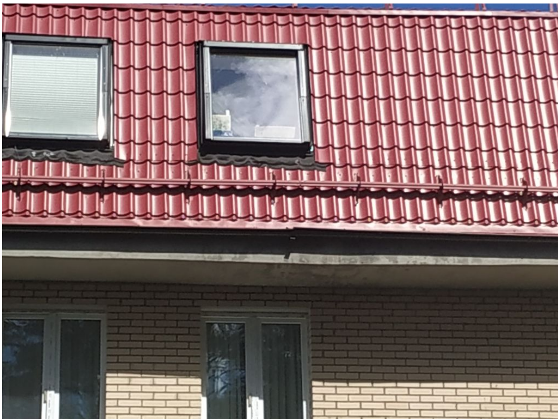
Фото 14. Следы увлажнения, высолы на карнизном свесе в местах соединения сегментов водосточного желоба. В осях «А-Г/5».
