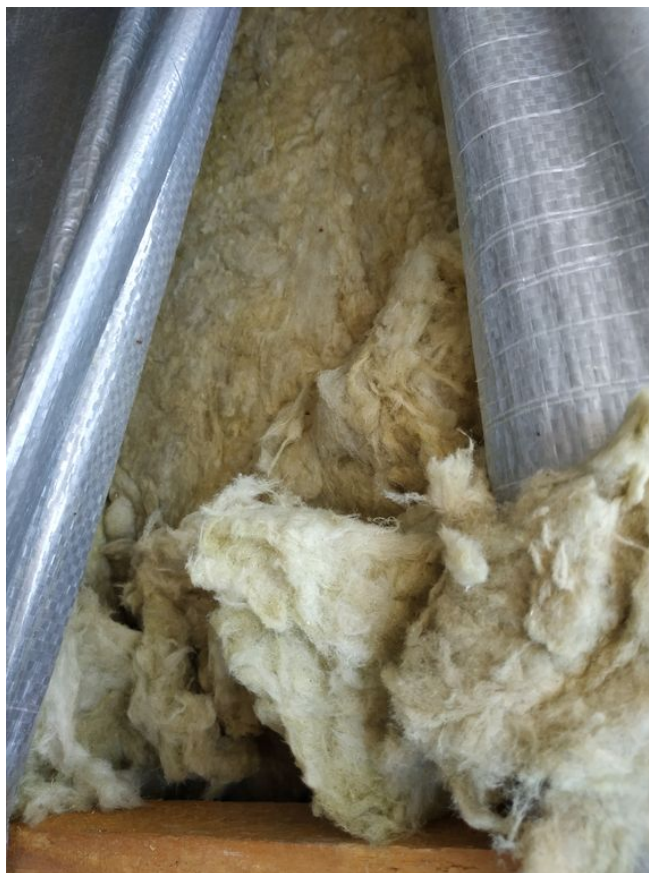
Фото 24. Отсутствует проклейка полотен гидроизоляции со стороны кровли. Утеплитель увлажнён.
