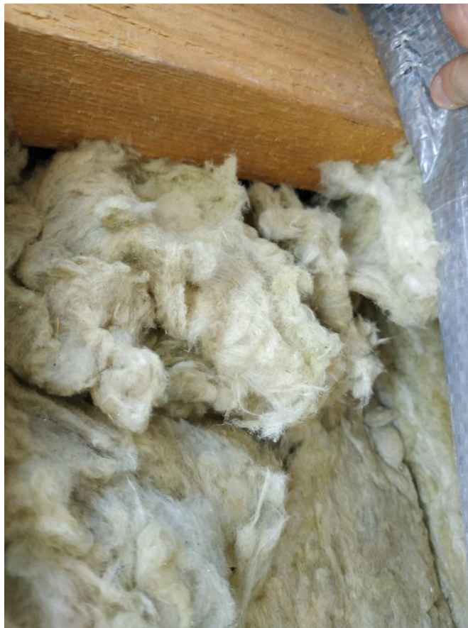
Фото 4.5. Вскрытие №1. Минераловатный утеплитель увлажнён, нарушена целостность при укладке («скомкан» при укладке).
