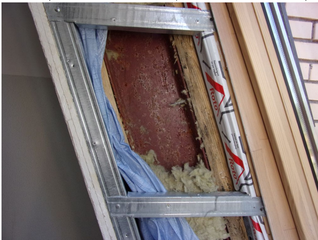
Фото 4.6. Вскрытие №2 в боковом откосе окна. Со стороны помещения утеплитель защищен пароизоляционной плёнкой. Стыки и нахлёсты пароизоляционной пленки не проклеены, не герметичны.
