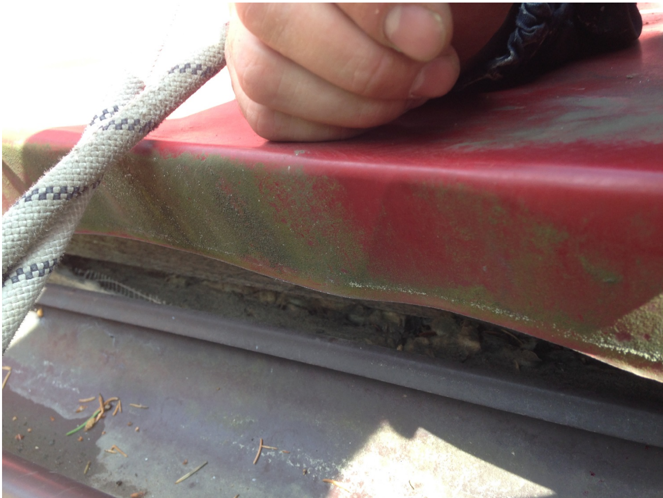
Фото 25. Отсутствует ветровая планка.
