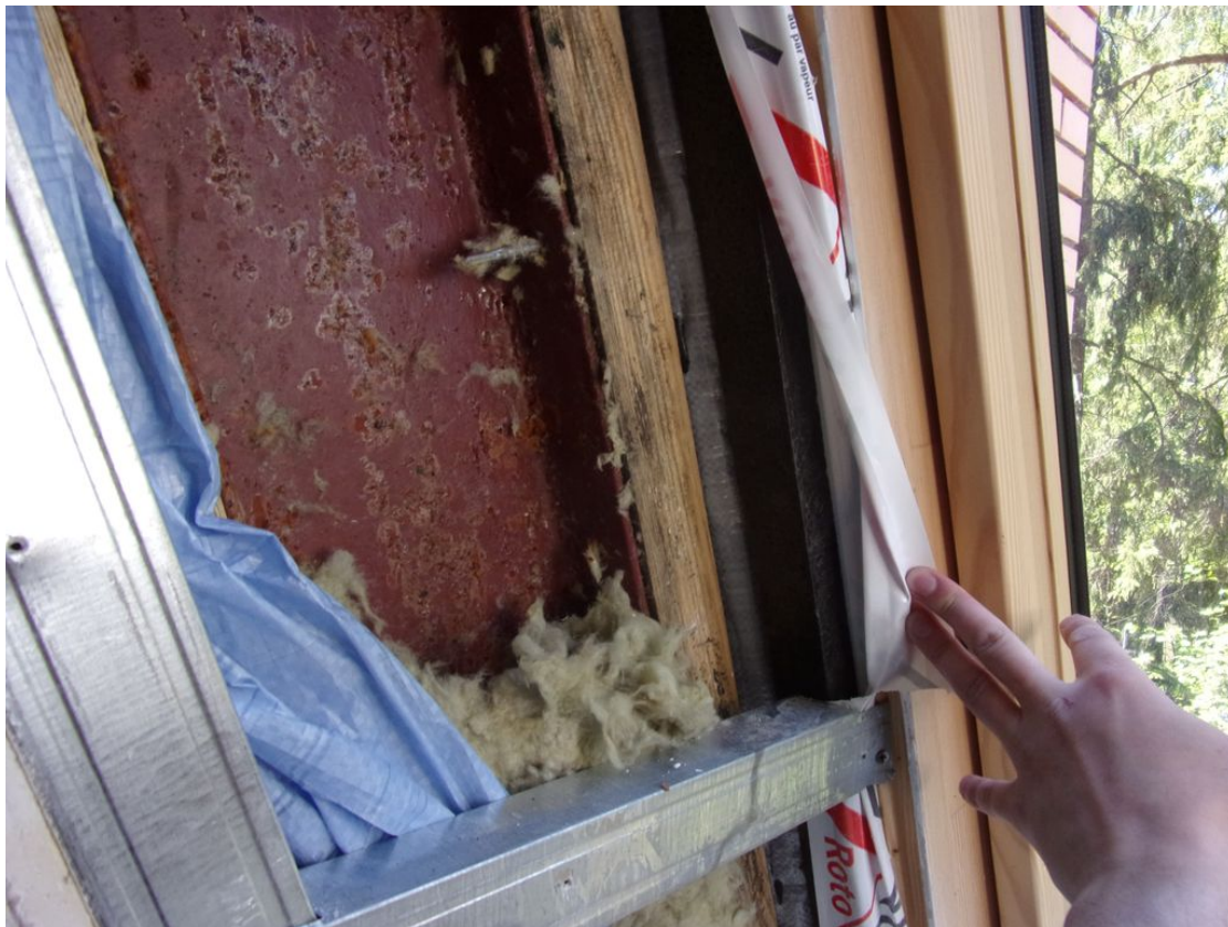
Фото 23. Следы коррозии на металлических стропилах. Контрбрус подвержен биопоражению.
