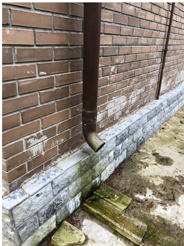
Фото 26. Биопоражение водосточной системы.
