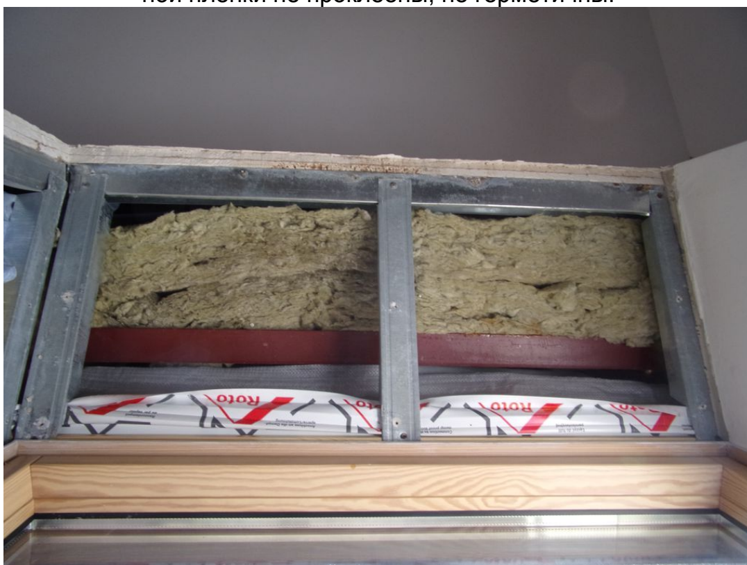
Фото 4.7. Вскрытие №1 в верхнем откосе окна. Примыкание гидроизоляционной плёнки к окну не герметично. Отсутствует пароизоляция под верхним откосом.
