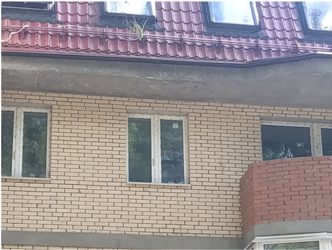
Фото 13. Следы увлажнения, высолы на карнизном свесе в местах соединения сегментов водосточного желоба (дефект встречается повсеместно). В осях «А/2-4».
