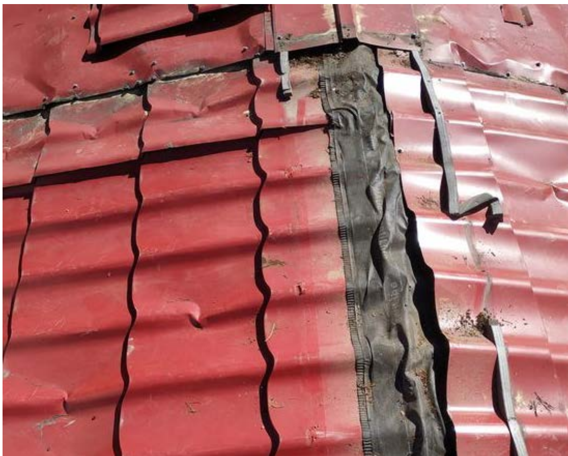
Фото 4.3. Вскрытие №1. Устройство конька не обеспечивает необходимую вентиляцию подкровельного пространства.
